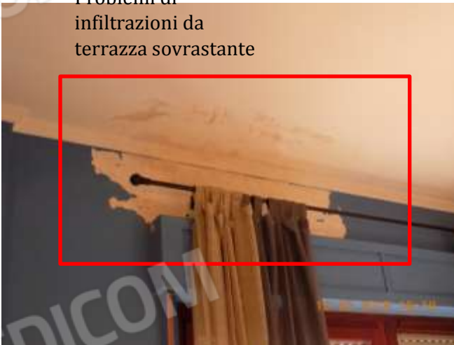
Foto11 Vista Probabili problemi di infiltrazioni zona Cucina
