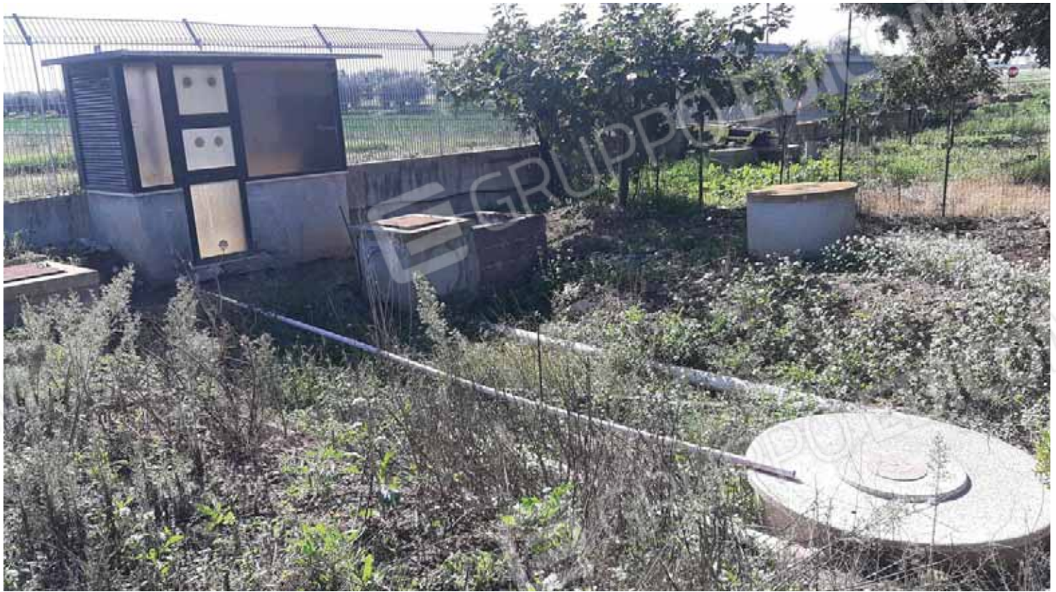
Foto terreno, Foglio 123, part. 45/59/100, impianti tecnologici
