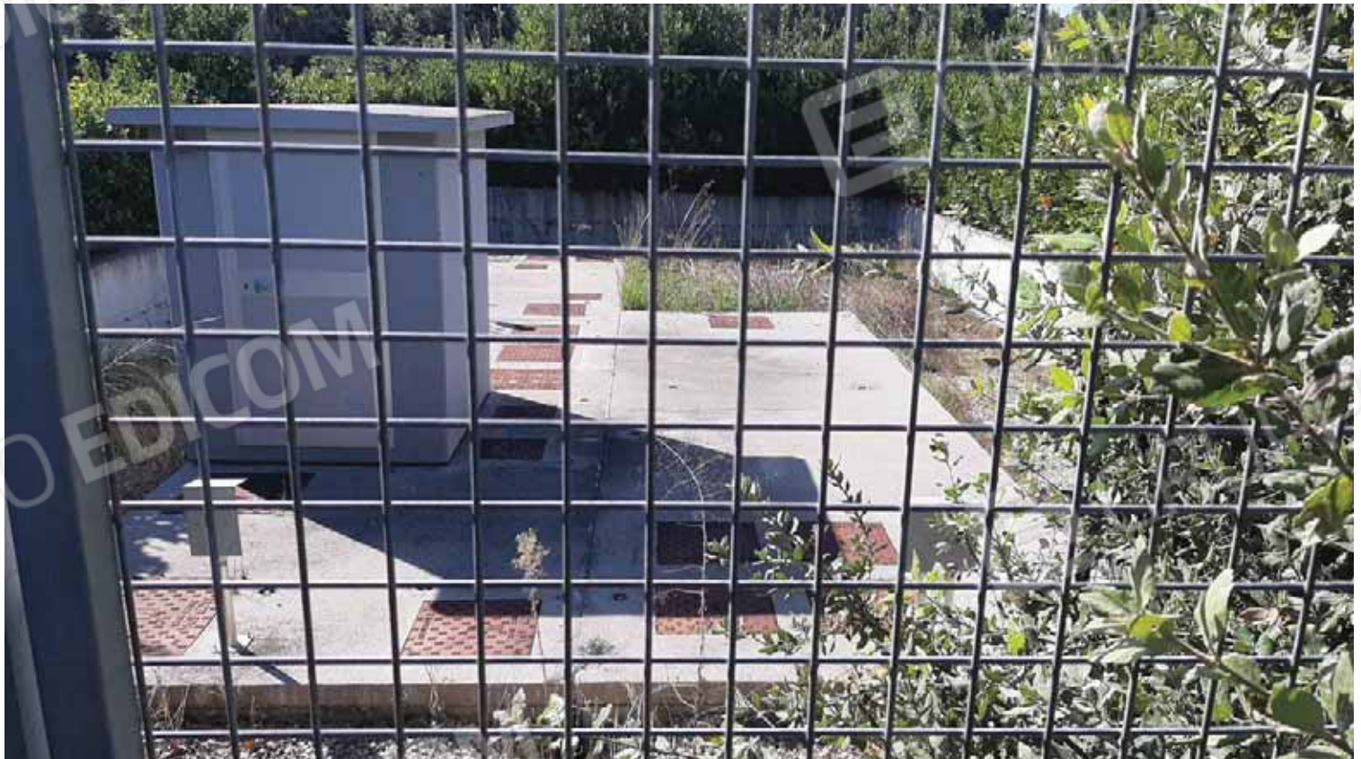
Foto terreno, Foglio 123, part. 45/59/100, impianti tecnologici.
