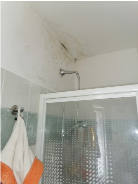
TRACCE DI CONDENZA
