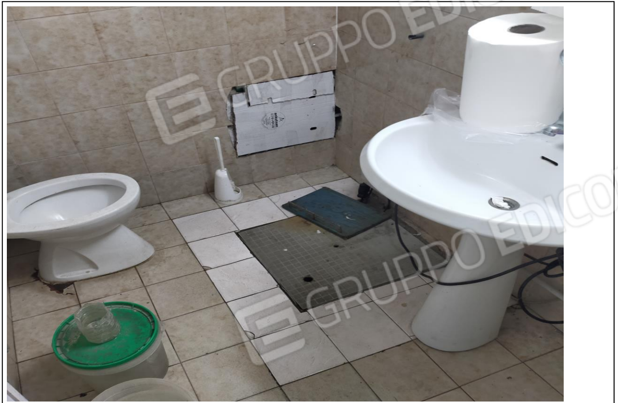
Foto 17 – bagno e pozzetto di sollevamento
