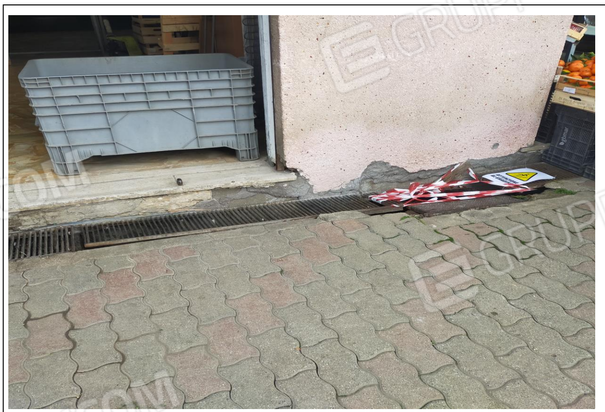
Foto 20 – foto della griglia condominiale
