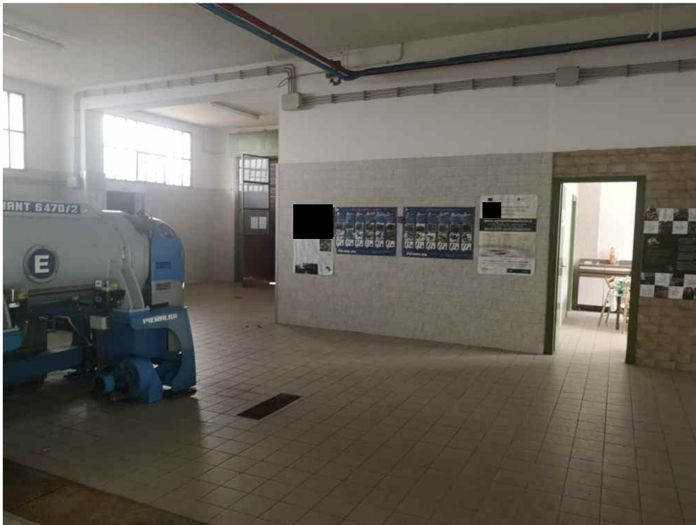
Foto n. 7 – Sala frantoio al piano terra
