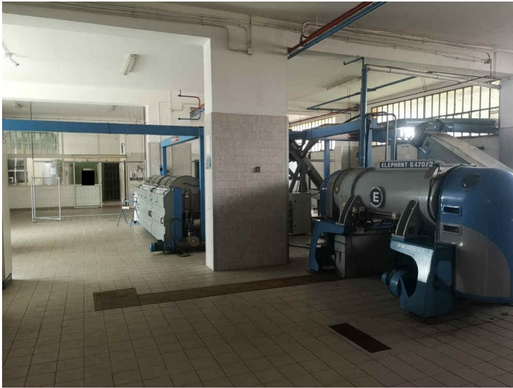
Foto n. 6 – Sala frantoio al piano terra
