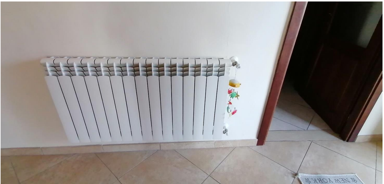
FOTO 15 Particolare elementi radianti
