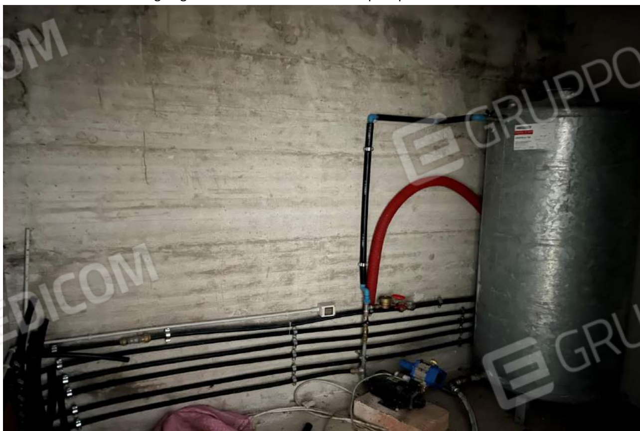
FOTO 22: Veduta interna cantina di pertinenza al garage censito al sub. 14 Lotto 1 corpo B piano terra
