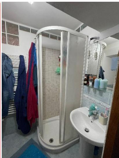
Bagno da ripristinare piano terra
