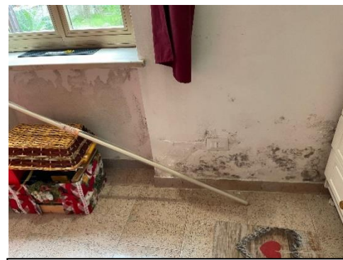
Infiltrazioni piano terra
