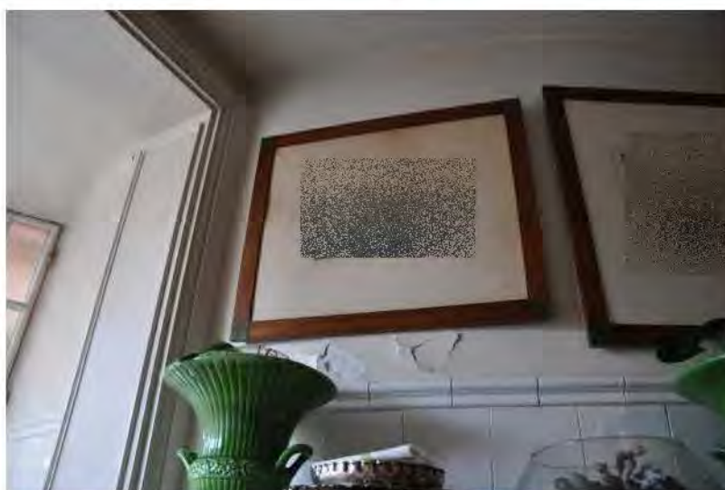
Distacco tinteggiatura zona cucina
