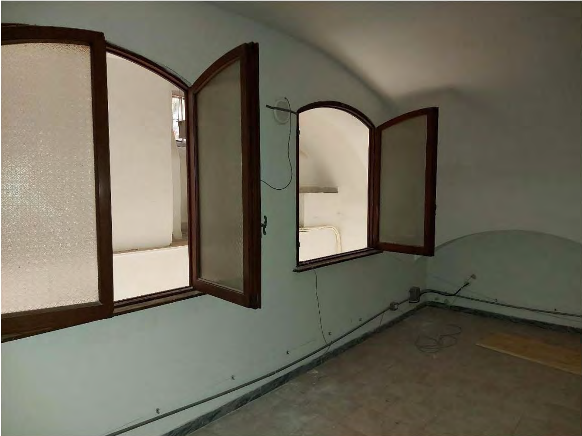
Locale "L" soppalco con finestre sul vuoto a doppia altezza dell'ambiente "G"
