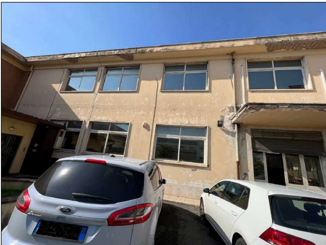
Stato conservativo della facciata con vista dalla corte antistante l'edificio
