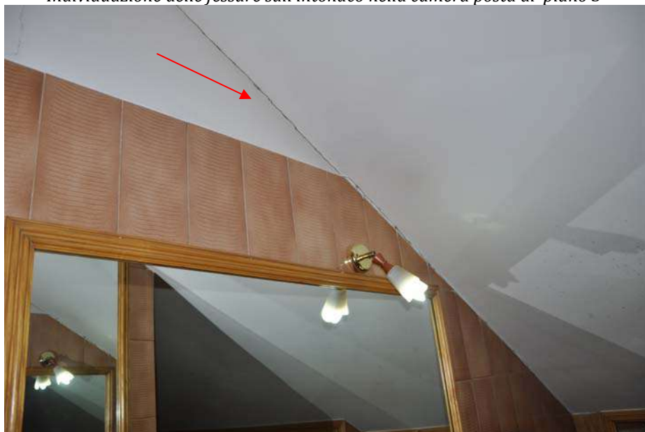
Individuazione delle fessure nel bagno posto al piano 3°
