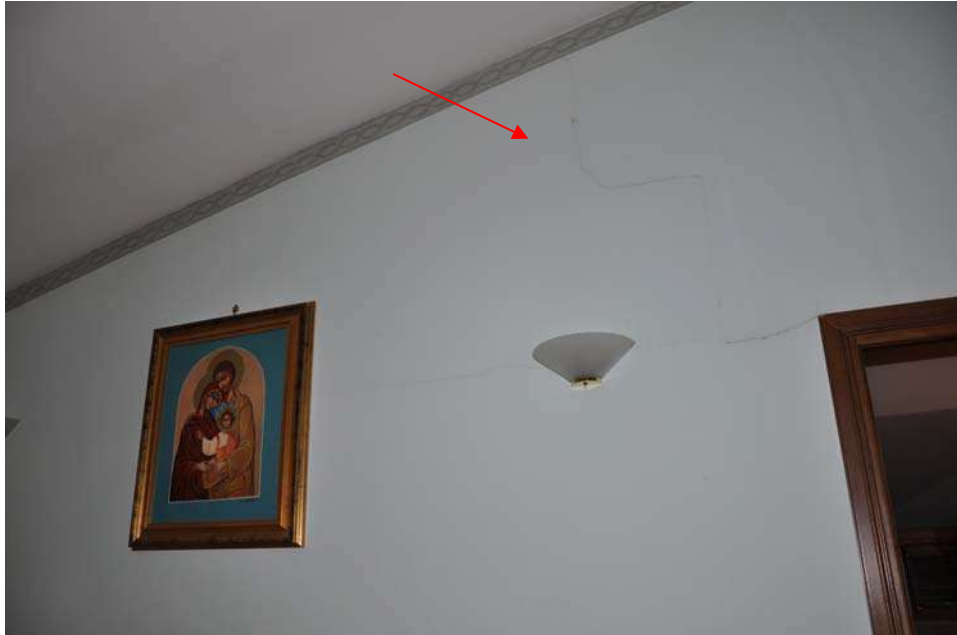
Individuazione delle fessure sull'intonaco nella camera posta al piano 3°
