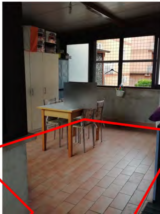
Chiusura abusiva – Piano primo Int. 3c
