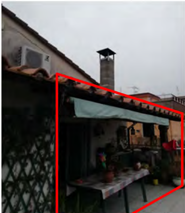
Tettoia abusiva int. 5 – Terzo piano
