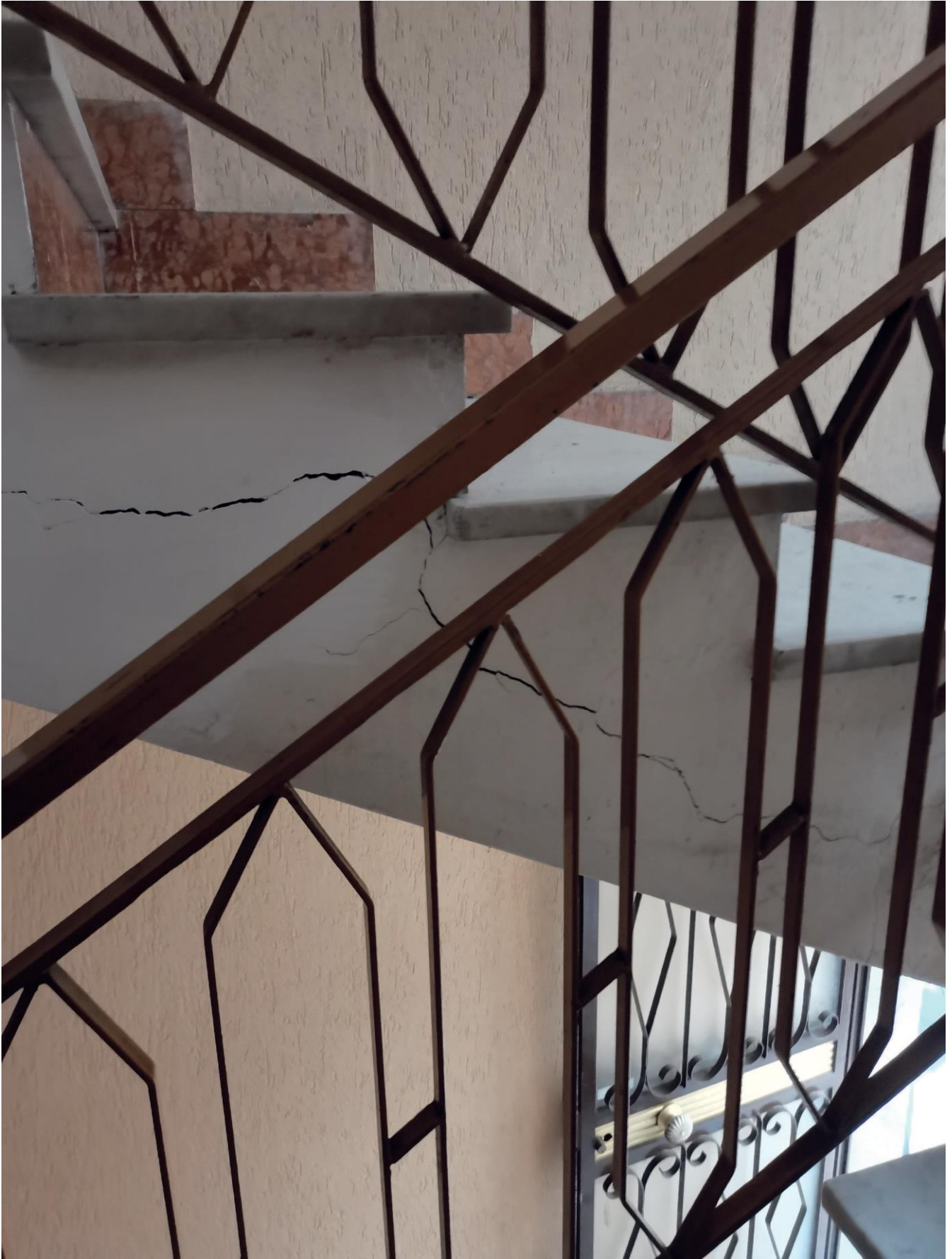
Particolare fessurazione rampa scala fabbricato
