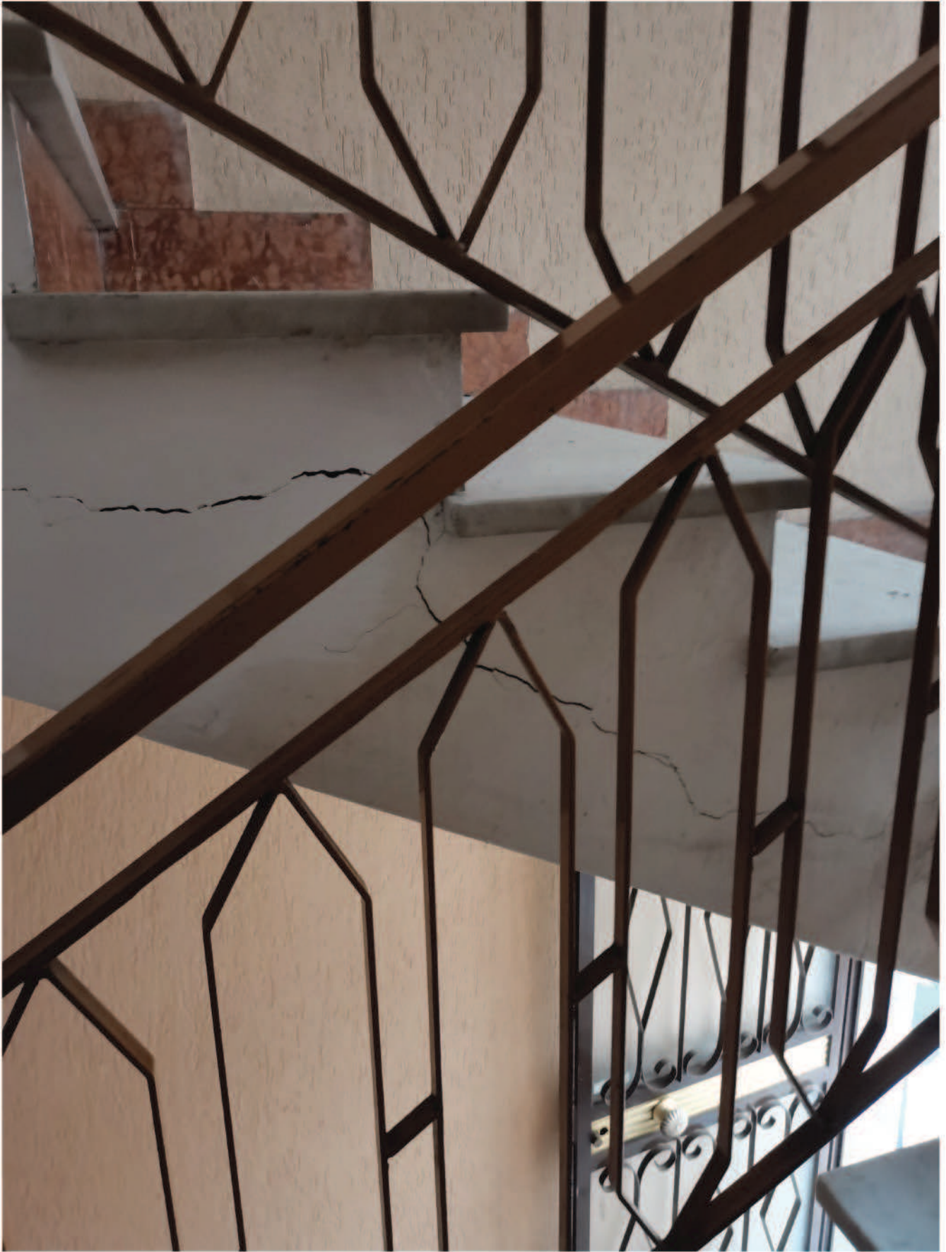
Particolare fessurazione rampa scala fabbricato
