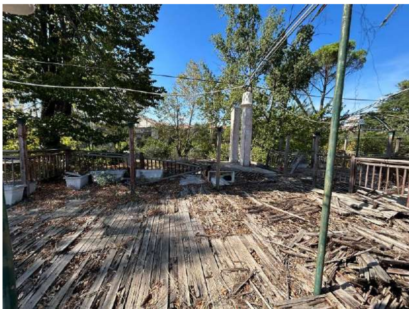
Lo stato di manutenzione della terrazza sovrastante l'ingresso al piano terra del ristorante al 30 settembre 2023
