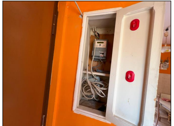
Quadro elettrico non a norma
