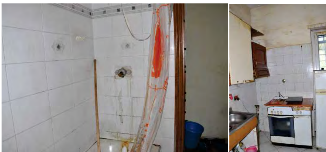
Macchie di muffa nell'abitazione
