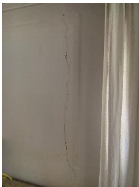
La lesione sull'intonaco presente nella stanza che affaccia verso il Viale di Castel Porziano
