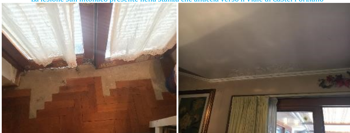
Il distacco dei listelli di parquet nella stanza in aderenza a quella di cui sopra e le tracce di umidità nel soggiorno
