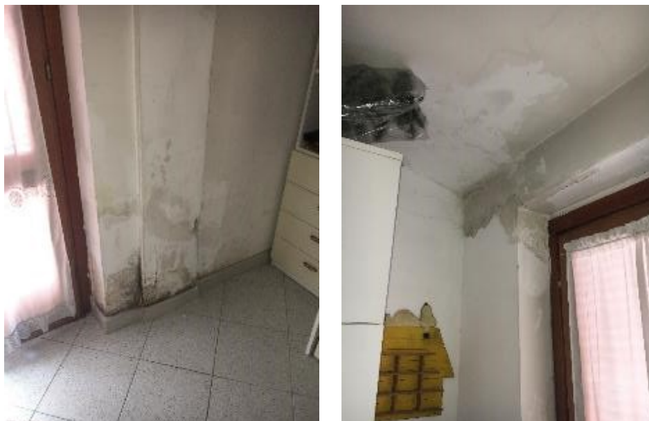
Lo stato conservativo della stanza più piccola che affaccia sul terrazzo
