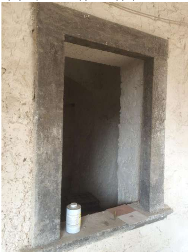
FOTO N. 32 – PARTICOLARE CORNICI IN PIETRA DELLE PORTE E FINESTRE DEL PORTICATO PIANO TERRA
