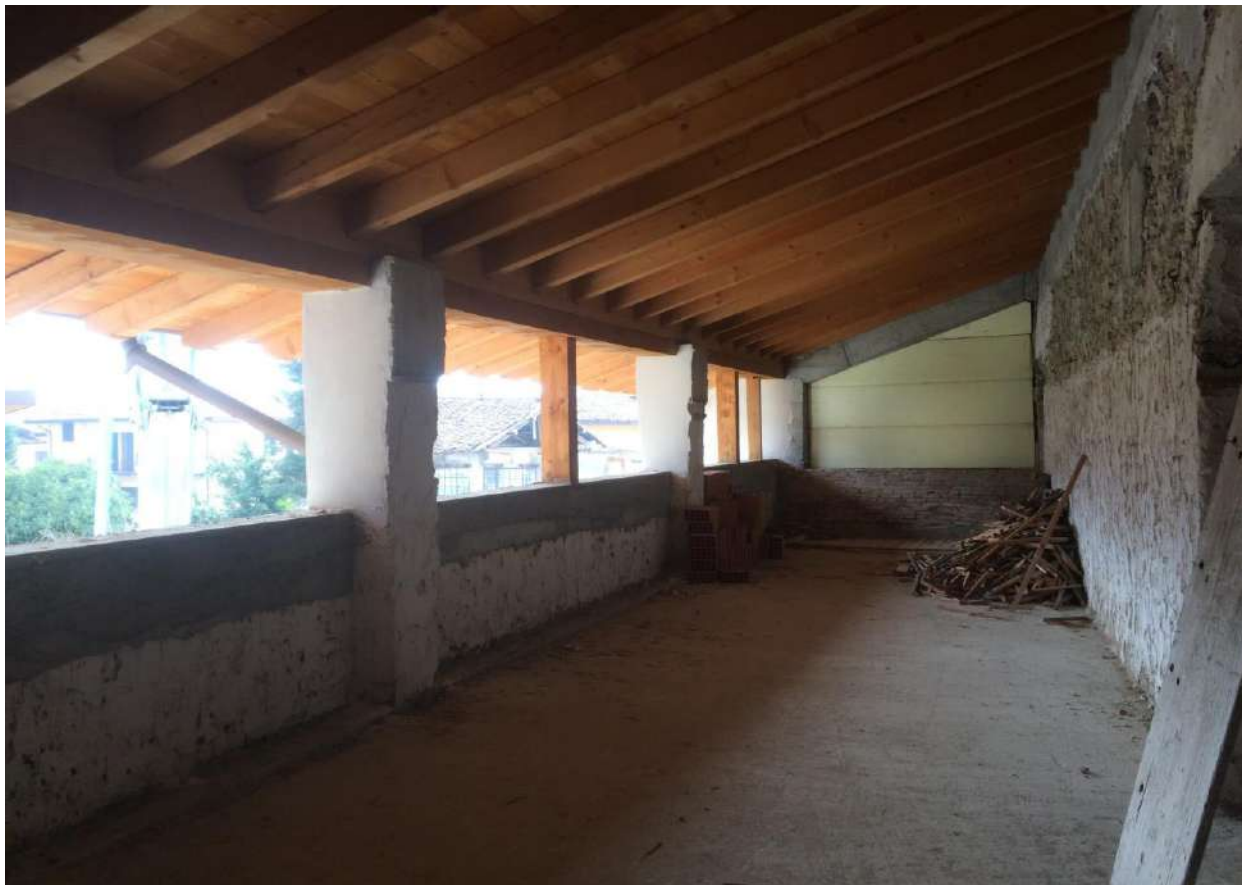
FOTO N. 23 – PORTICATO PIANO SECONDO vista parete lato esterno
