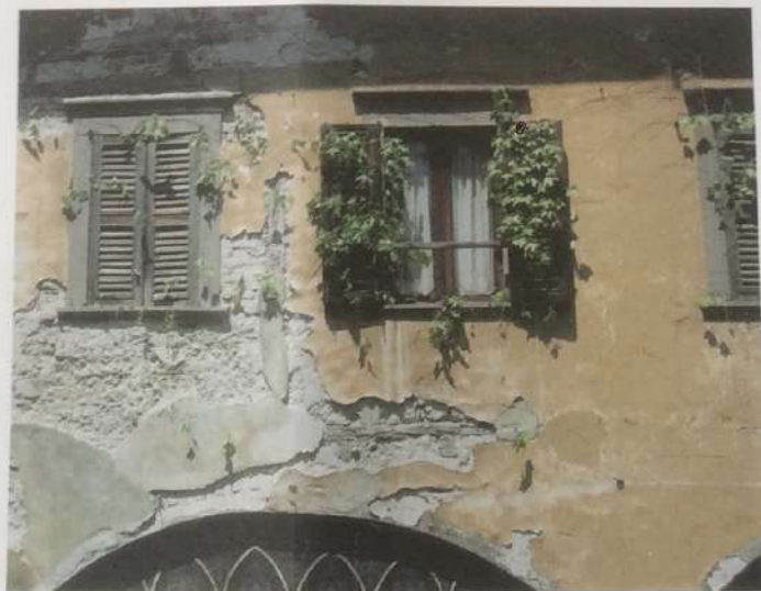
40. Esempio di degrado intonaco
