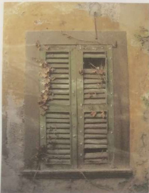
37. Esempio di degrado ante e serramenti
