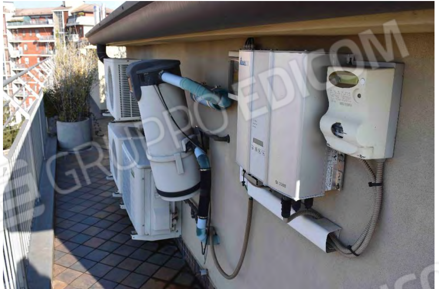
Balconata Ovest, impianti tecnici.
