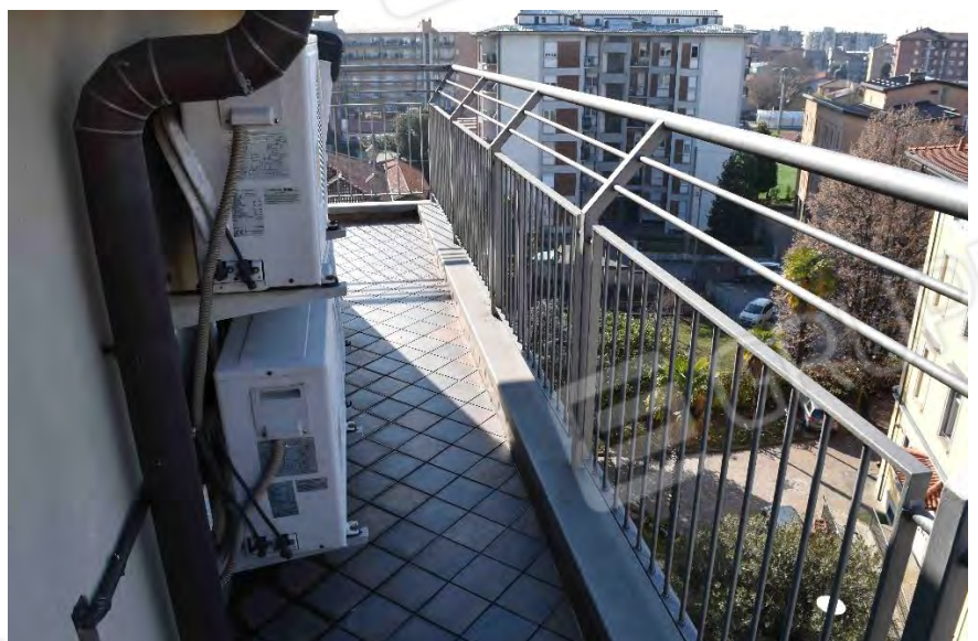
Balconata Ovest, impianti tecnici.
