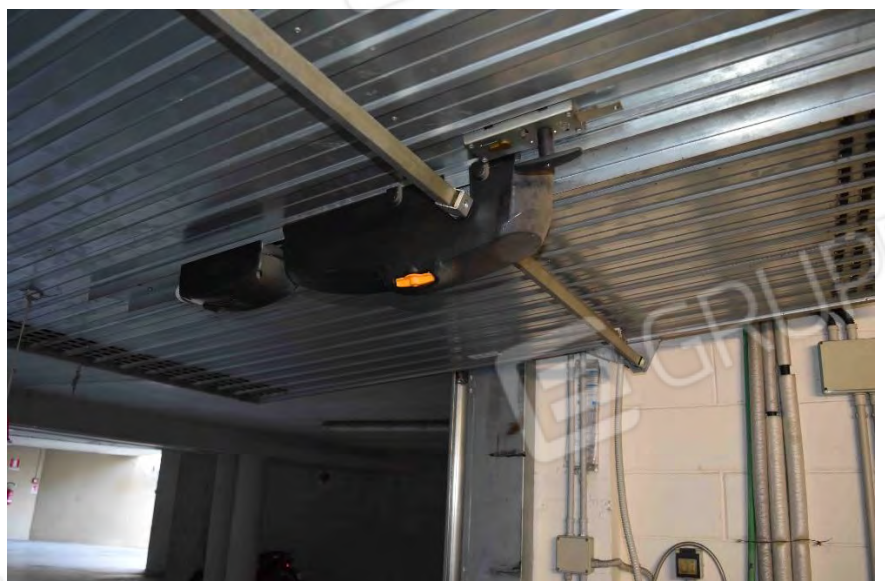
Autorimessa, automatismo serranda.
