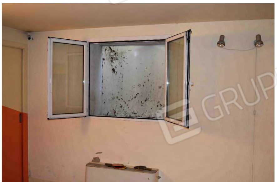
P.I. - Magazzino/Sala Giochi, ventilazione.
