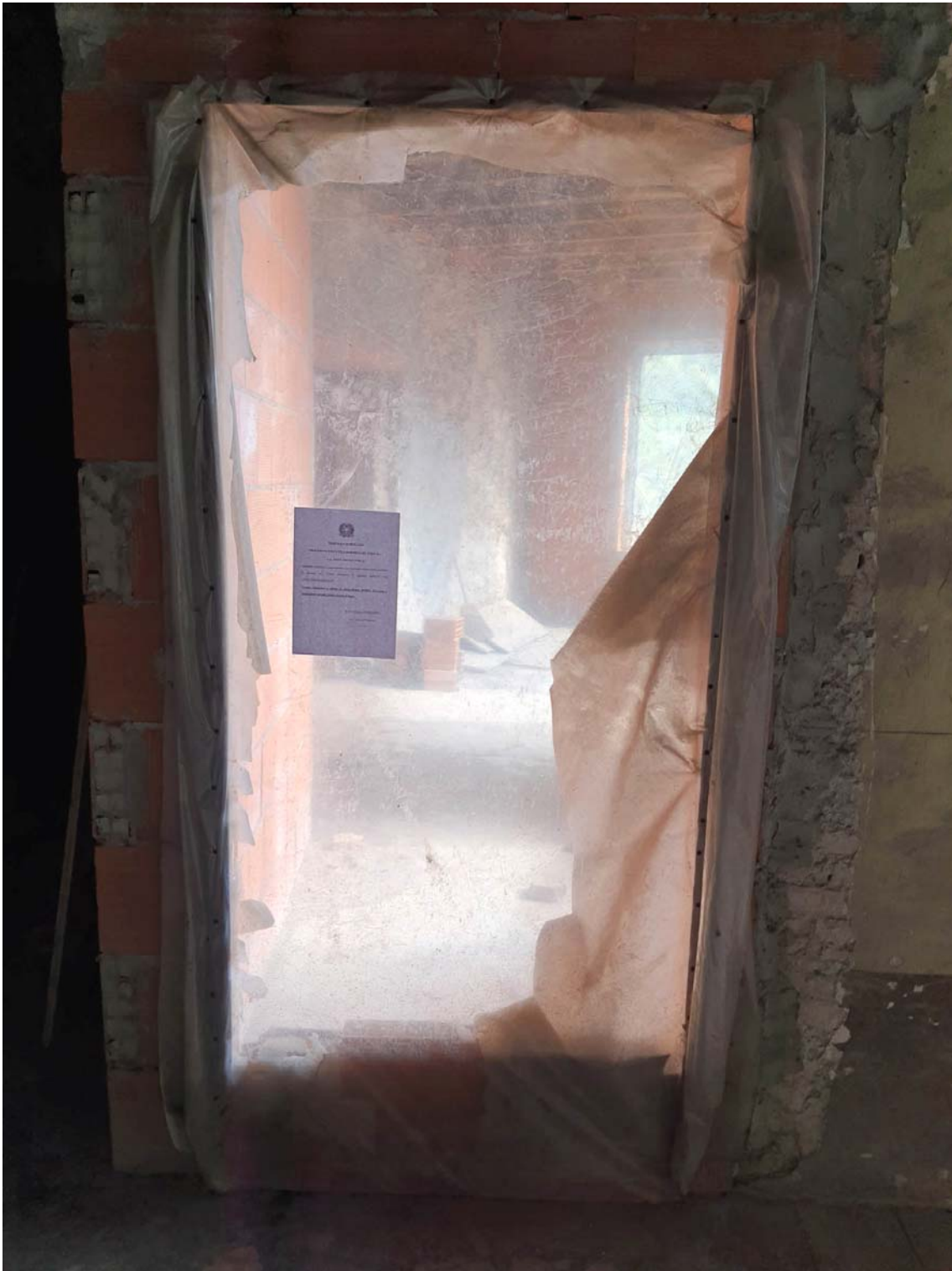
RILIEVO PARTI COMUNI INTERNE – Foto 23. Ripresa del varco (porta) di accesso all'Unità Immobiliare 2 da progetto* (Subalterno 4). Si noti l'avviso di immobile sottoposto a procedura apposto dal Custode dei beni incaricato. (Nota *: si vedano le planimetrie di rilievo peritale e il progetto preliminare proposto in sede di Procedura Fallimentare n. 171/2002).
