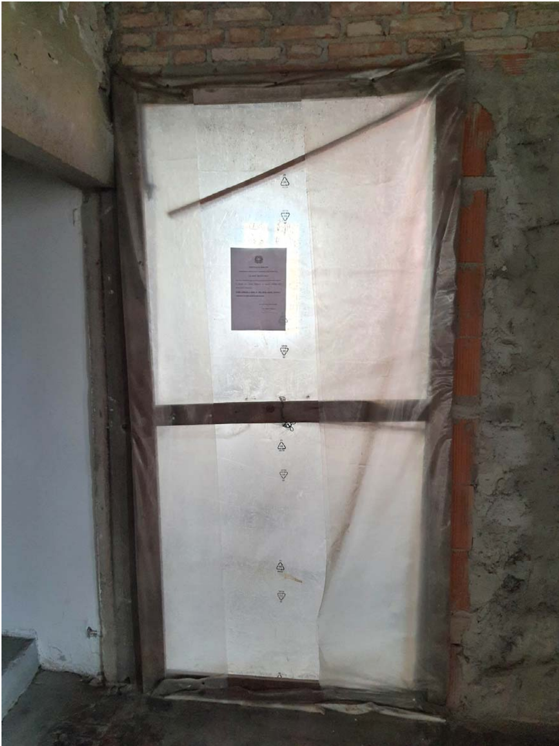
RILIEVO PARTI COMUNI INTERNE – Foto 22. Ripresa del varco (porta) di accesso all'Unità Immobiliare 1 da progetto* (Subalterno 4). Si noti l'avviso di immobile sottoposto a procedura apposto dal Custode dei beni incaricato. (Nota *: si vedano le planimetrie di rilievo peritale e il progetto preliminare proposto in sede di Procedura Fallimentare n. 171/2002)
