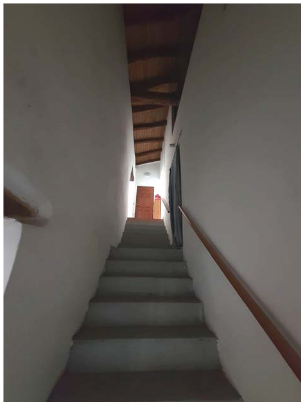
RILIEVO INTERNO – Foto 73 e 74. Viste della rampa scale di collegamento con il secondo piano.
