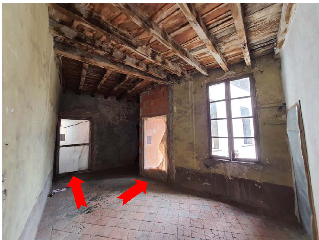
RILIEVO INTERNO – PRIMO PIANO – Foto 34. Ripresa del disimpegno comune al primo piano del fabbricato. Dettaglio accessi alle unità immobiliari 1 (a sx) e 2 (a dx) di progetto.
