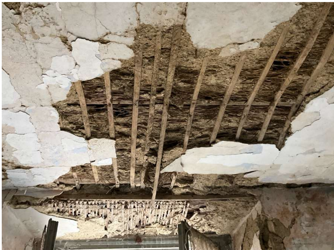
Foto n. 23 | Primo Piano: cedimento del controsoffitto in incannucciato.
