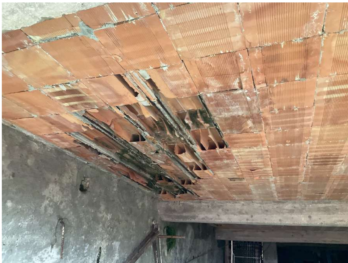
Foto n. 12 | Sfondellamento del solaio in laterocemento del porticato.
