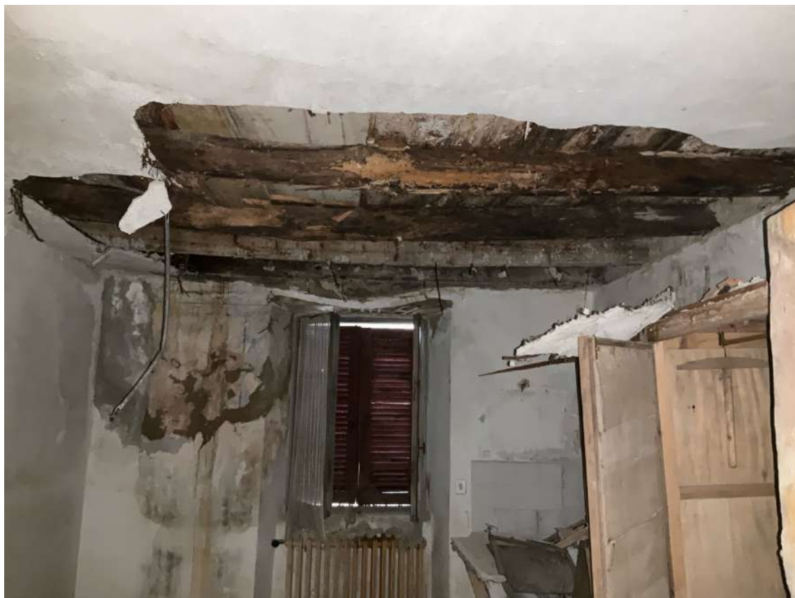
Foto n. 33 | Vista di una camera d'albergo con il soffitto dissestato.
