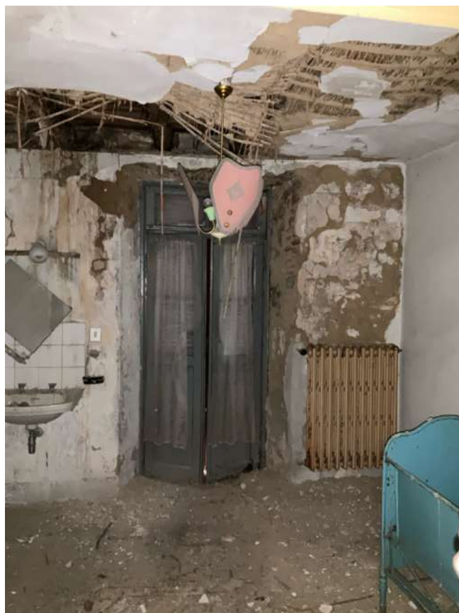
Foto n. 34 | Secondo Piano: vista di una camera d'albergo con il soffitto dissestato.
