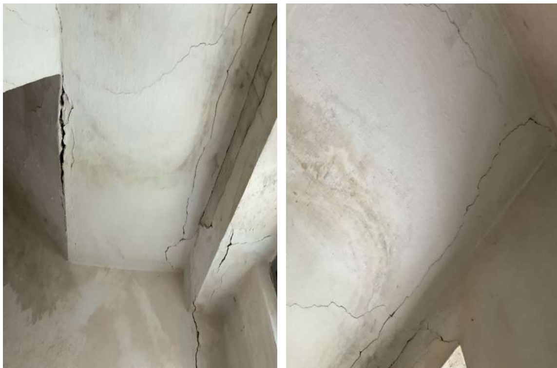
Foto n. 31 | Secondo Piano: fessurazioni nell'intonaco.
