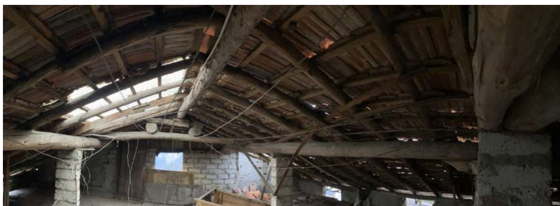
Foto n. 36 - 37 | Vedute del sottotetto con diverse lacune nel manto di copertura.
