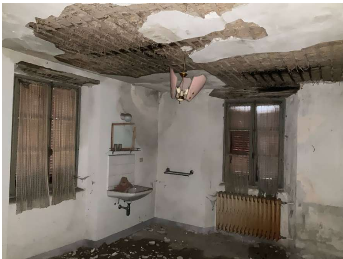
Foto n. 32 | Secondo Piano: vista di una camera d'albergo con il soffitto dissestato.
