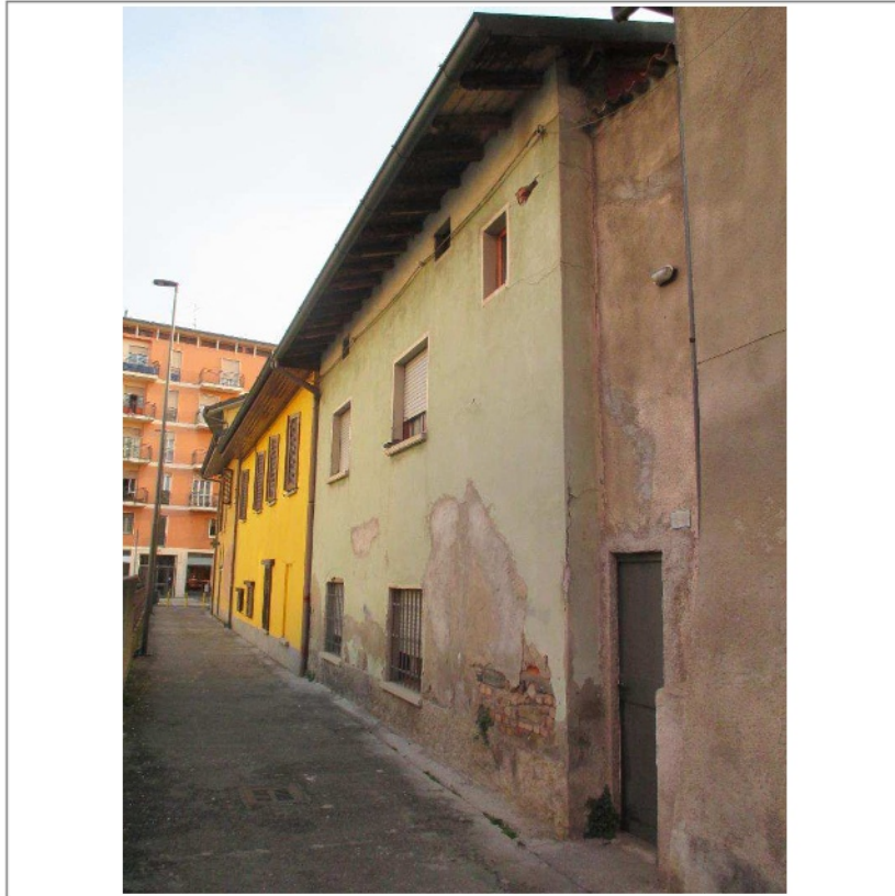
- Casa di civile abitazione - Fronte est su via pubblica detta via B. Colleoni -
