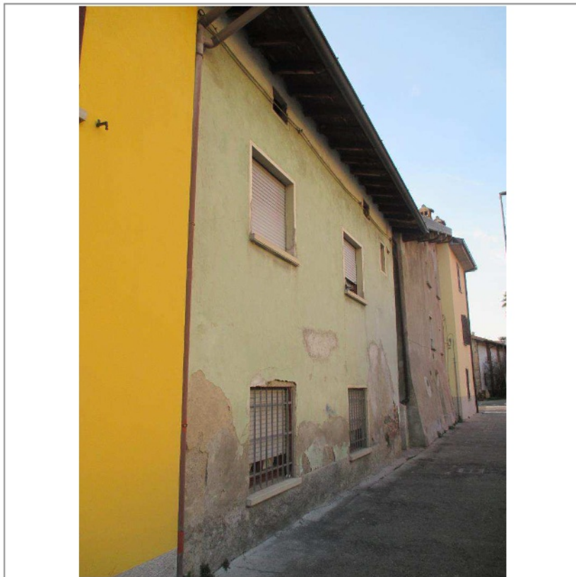
- Casa di civile abitazione - Fronte est su via pubblica detta via B. Colleoni -
