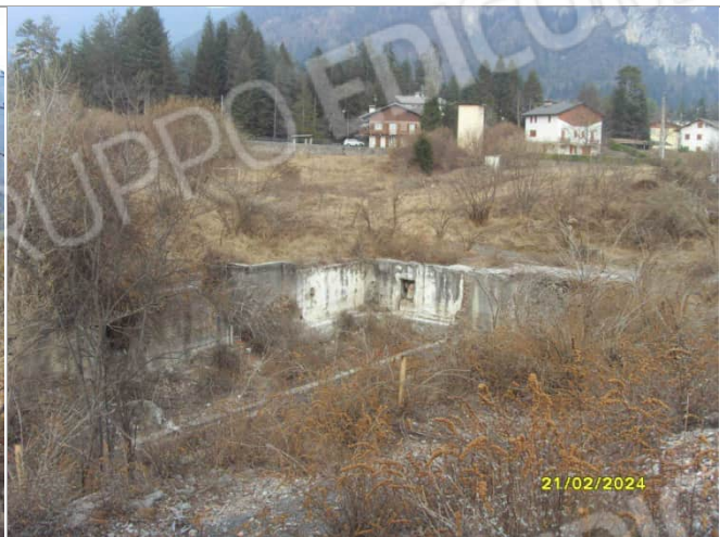
Fabbricato oggetto di demolizione non completamente demolito
