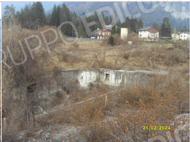
Fabbricato oggetto di demolizione non completamente demolito
