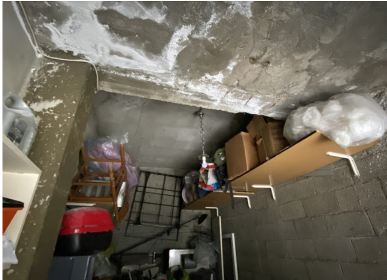
Infiltrazioni di acqua piovana all'interno dell'autorimessa provenienti dalla sovrastante copertura a verde condominiale
