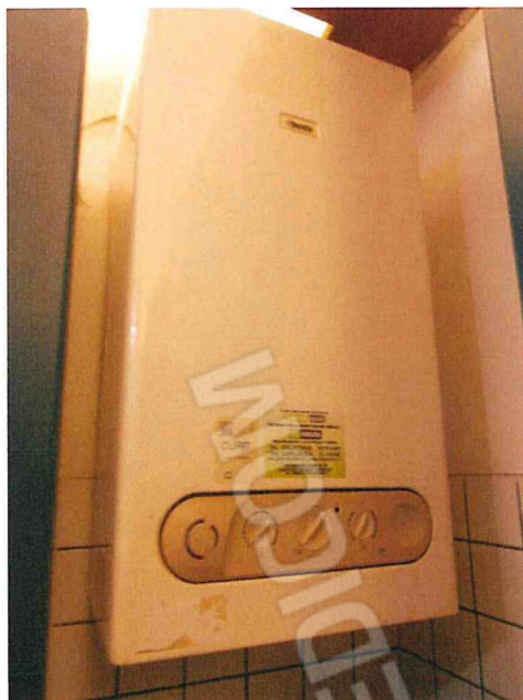
Foto 11 - interno - caldaia autonoma
