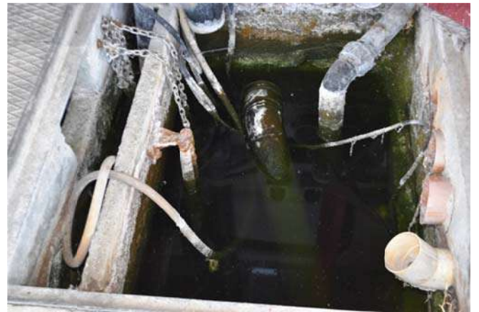
44 – Pompa di pescaggio
