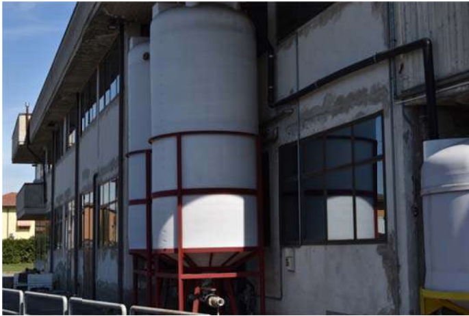
43 – Serbatoi con supporto 14 mila litri
