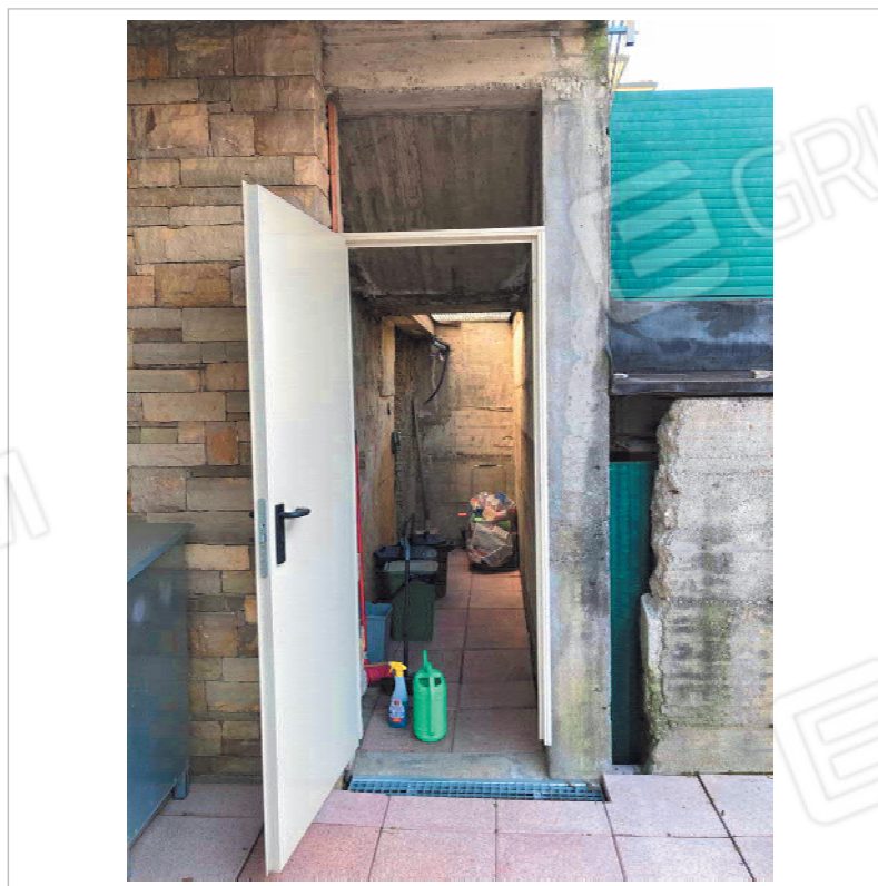
L'accesso alla caldaia
