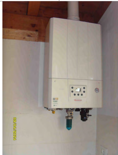
Caldaia interna – zona cottura
