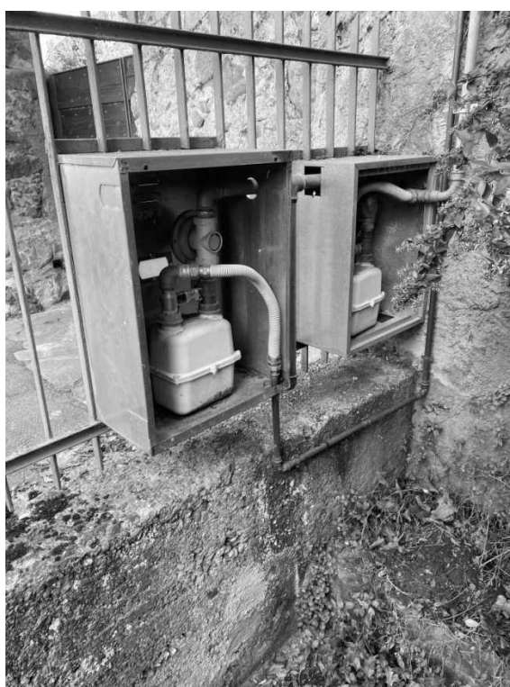
Punto di fornitura gas metano (Cespite 2)
