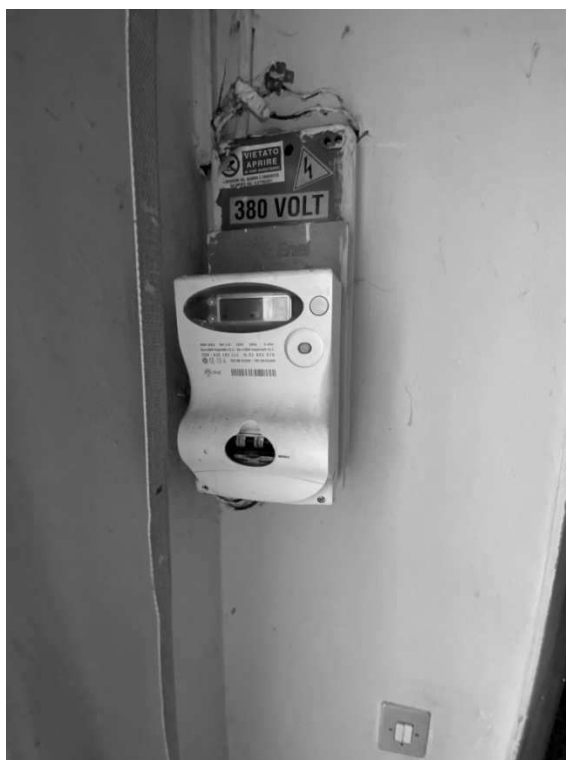
Punto di presa elettrica disattivo (Cespite 2)
