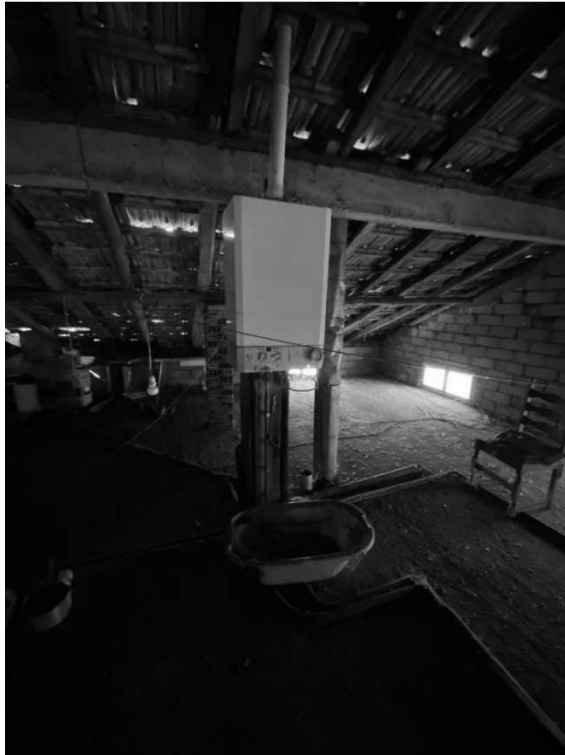
Generatore di calore esistente (Cespite 2)
