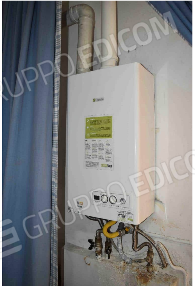
PT, caldaia riscaldamento e ACS.
