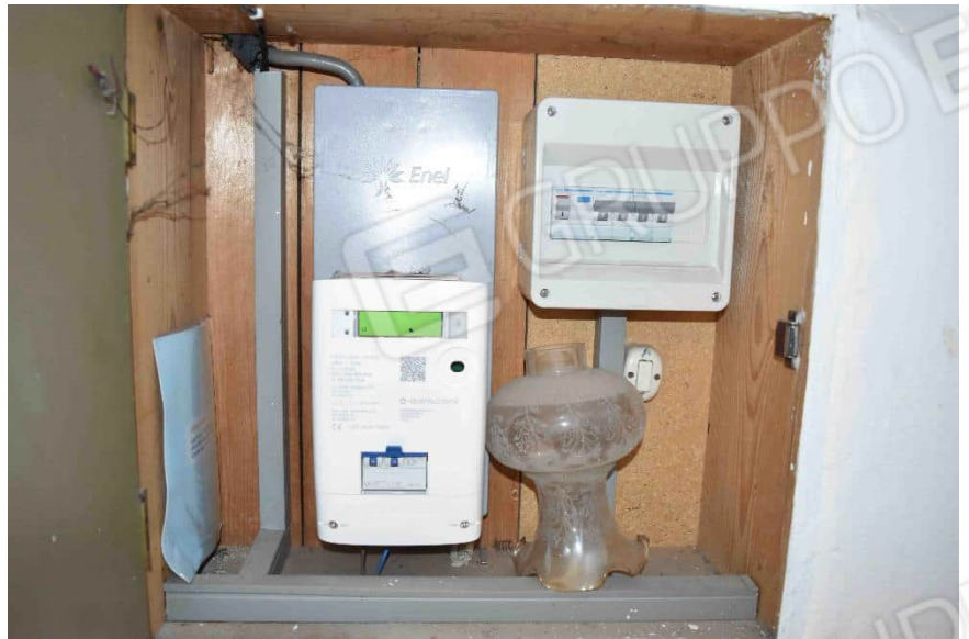
PT, quadro elettrico.
