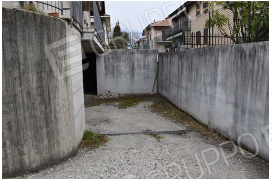
Foto n. 5 Scivolo di accesso al piano interrato (manca la avimentazione)
