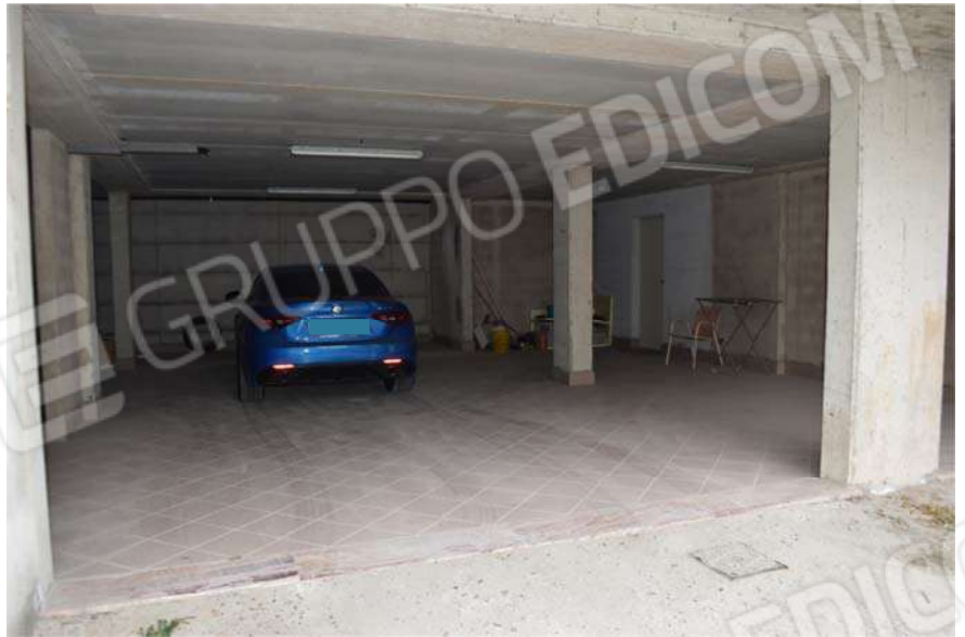
Foto n. 4 Autorimessa al piano interrato (manca porta basculante di chiusura)
