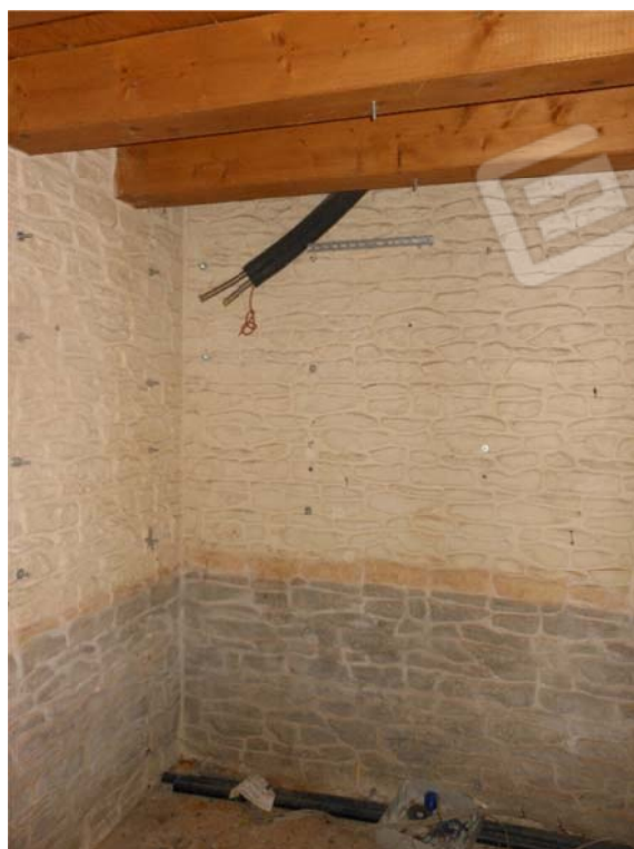
Foto 19: Particolare locale tecnico piano interrato
