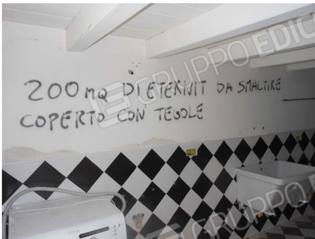
Foto 33: Dichiarazione presenza di eternit in copertura
