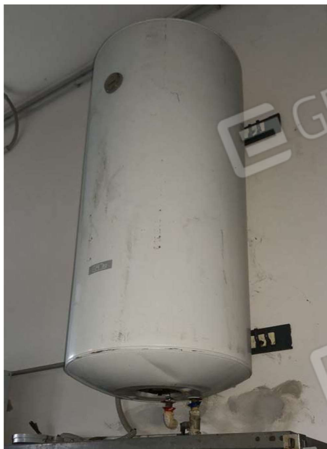
Fig. 39 – Boiler elettrico che consente la produzione di acqua calda sanitaria nei bagni presenti al piano primo.
