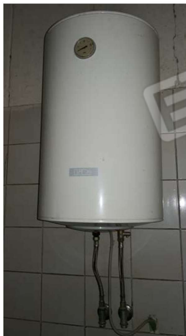
Fig. 32 – Boiler elettrico che consente la produzione di acqua calda sanitaria nei bagni presenti al piano terra.
