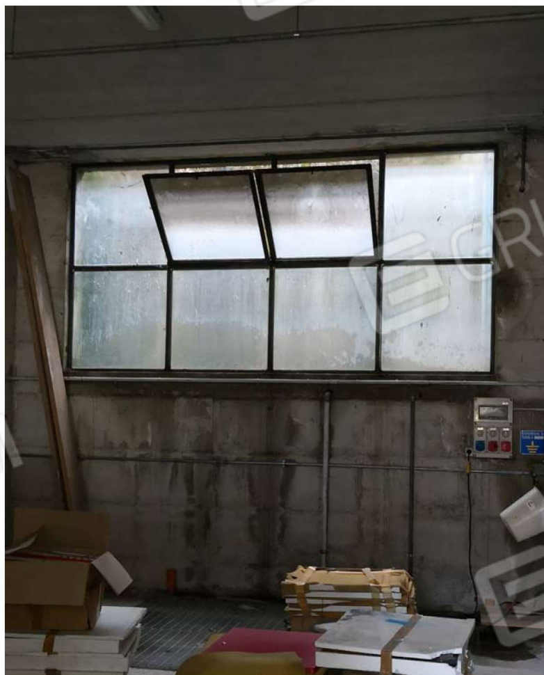
Fig. 22 – Vista interna del magazzino interrato. Il serramento presente nella fotografia è oggetto di abuso.
