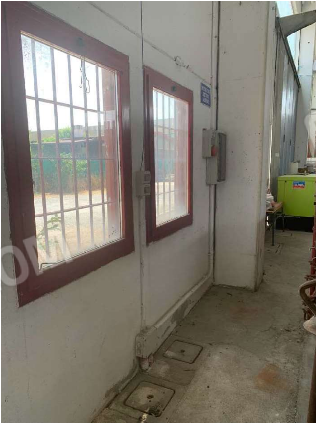
Foto 15. Quadro elettrico interno al capannone
