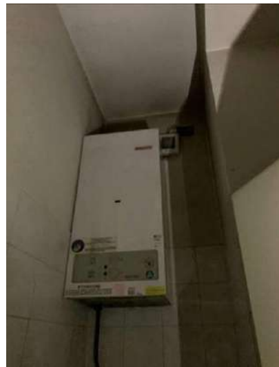
Figura 26: Tipologia di caldaia installata nel locale wc a lato della quale si vede l'impianto di aspirazione presente
