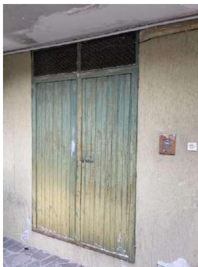
Figura 20: Ingresso del locale centrale termica comune posto al di sotto della terrazza
