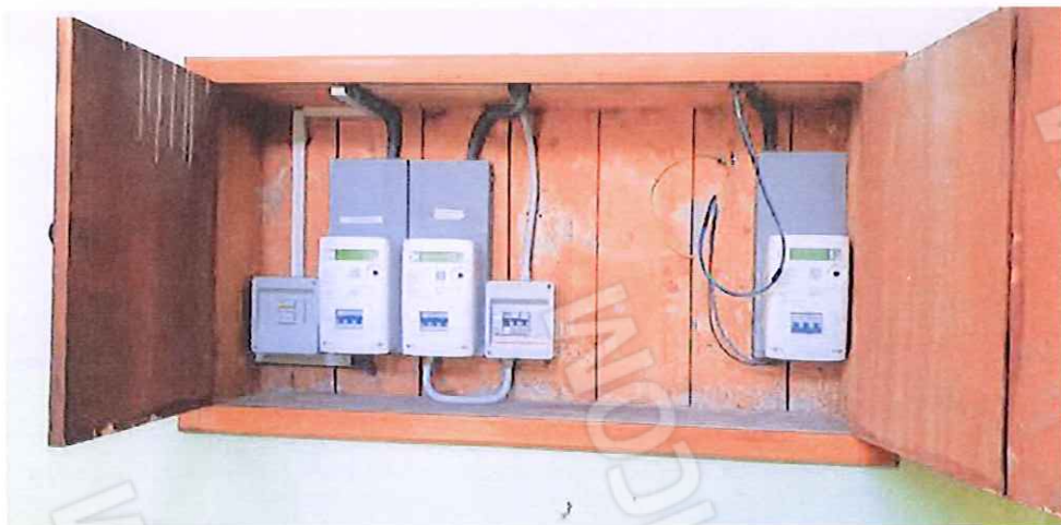
Foto 20 – Vano contatori- pianerottolo 2° piano
