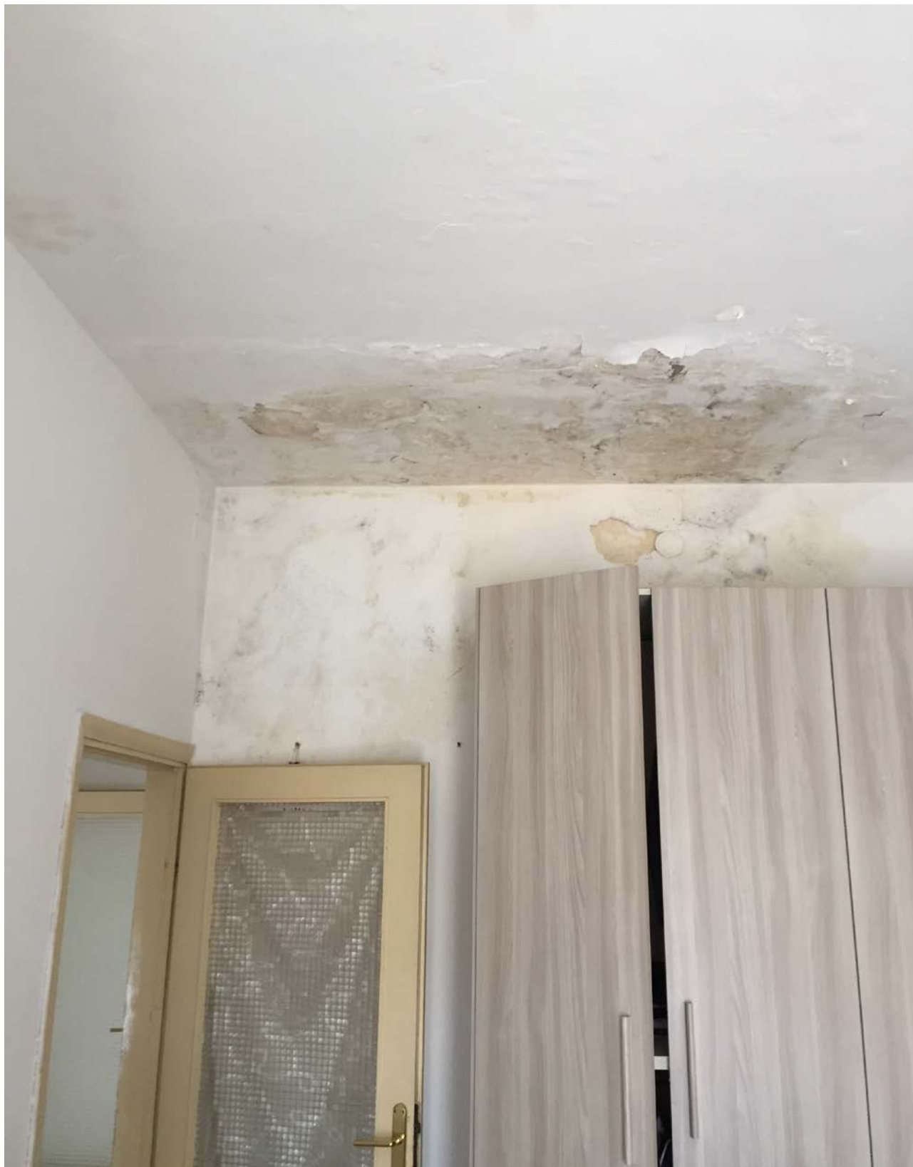
Foto interna dell'appartamento al lotto 1C con l'evidenziazione dei problemi di infiltrazioni meteoriche dalla soprastante copertura, anche se recentemente sistemata. (così sembra dai sopralluoghi).
