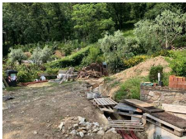
Figura 35: Presenza di scavi aperti per sottoservizi non ancora completati in direzione dell'autorimessa e della taverna non annesse all'edificio principale
