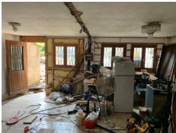
Fig. 24: Taverna e autorimessa interessate da lavori non completati
