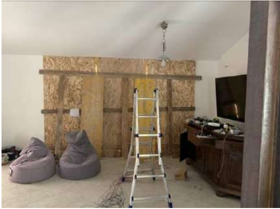
Figura 38: Piano terra abitazione, serramento soggiorno non ancora installato e componentistica elettrica a terra
