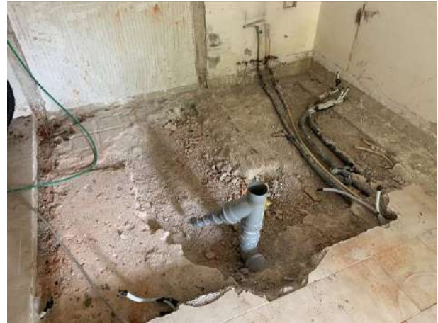
Figura 45: Autorimessa e taverna, stato impiantistica bagno
