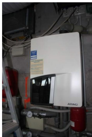
Foto 7 - Particolare caldaia sub. 6
