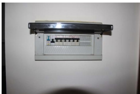
Foto 15 Impianto elettrico a norma
