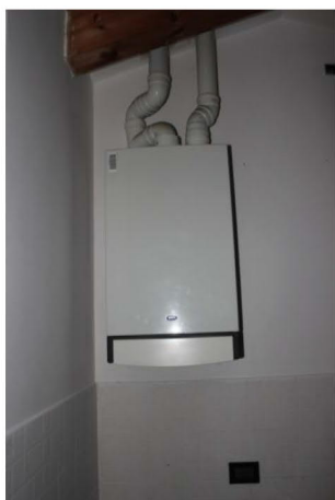
Foto 5 – Caldaia angolo cottura sub. 3
