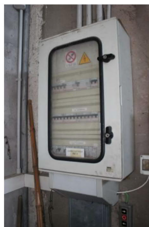
Foto 6 - Particolare quadro elettrico sub. 6
