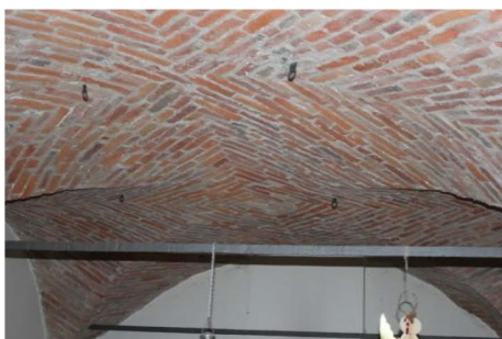
Foto 17 – soffitto soggiorno sub. 9
