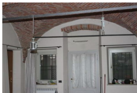
Foto 16 – soffitto soggiorno sub.9
