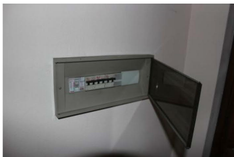
Foto 7 sub 61 Impianto elettrico a norma
