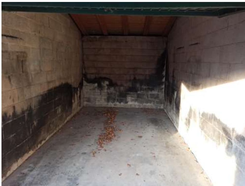
Foto 9.02: vista interna autorimessa – visibili segni dovuti ad un incendio
