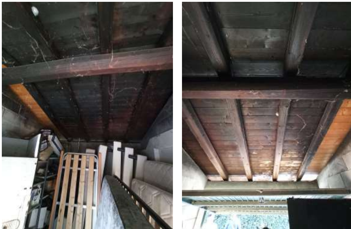
Foto 10.03 e 10.04: viste copertura in legno soggetta ad incendio
