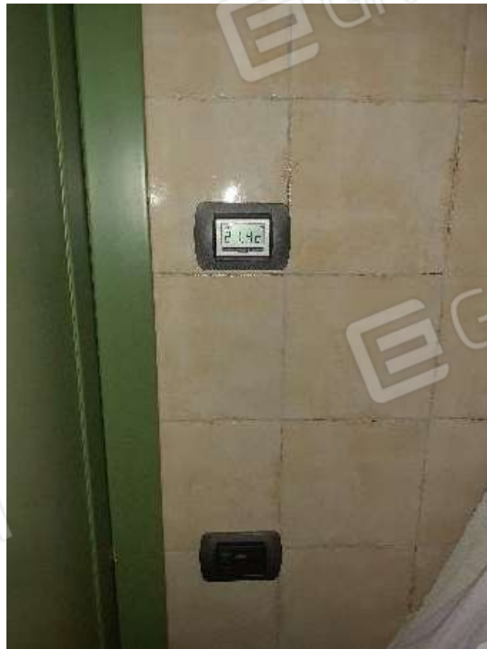
Termostato di zona in bagno
