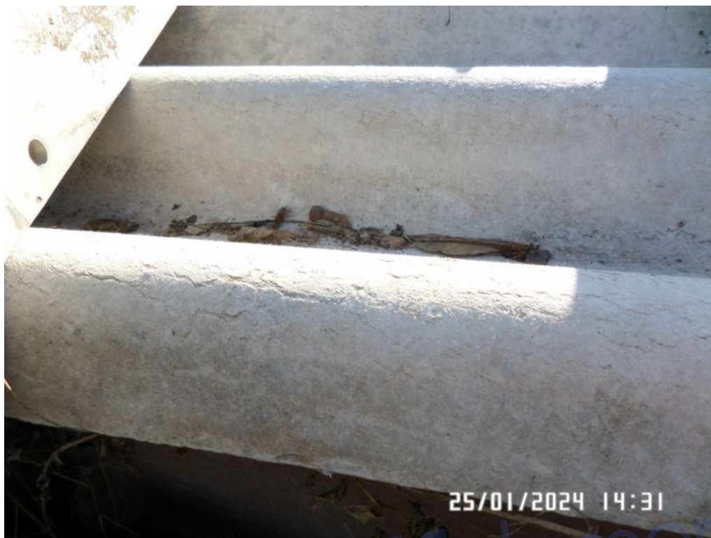
Foto 9: Lastre "B", particolare dello sfaldamento superficiale
