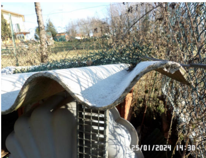
Foto 8: Lastre "B", estremità friabili
