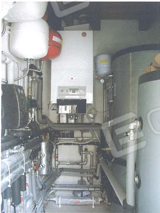
Fotografia centrale termica Lotto 2
