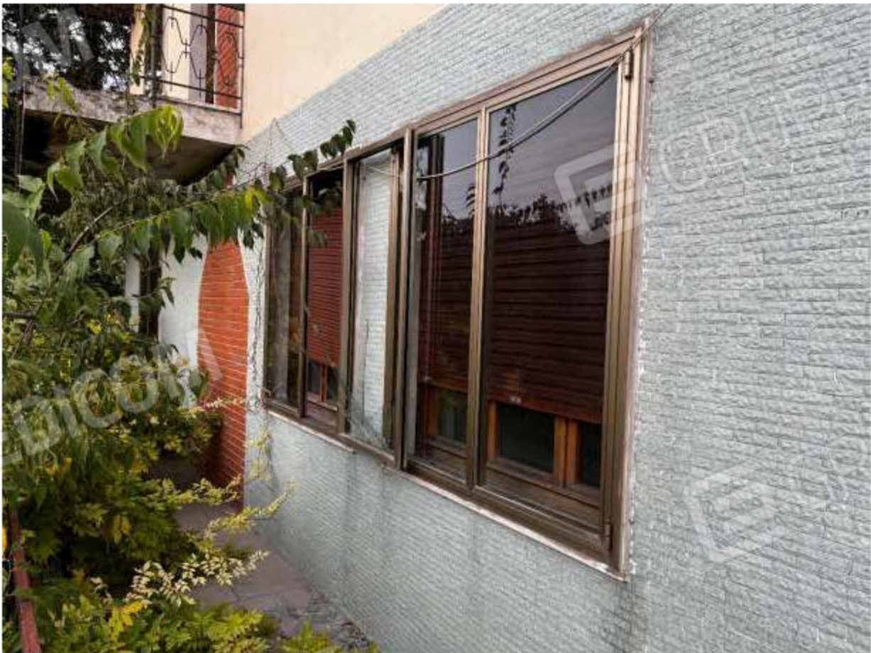
SERRAMENTO ESTERNO ROTTO
