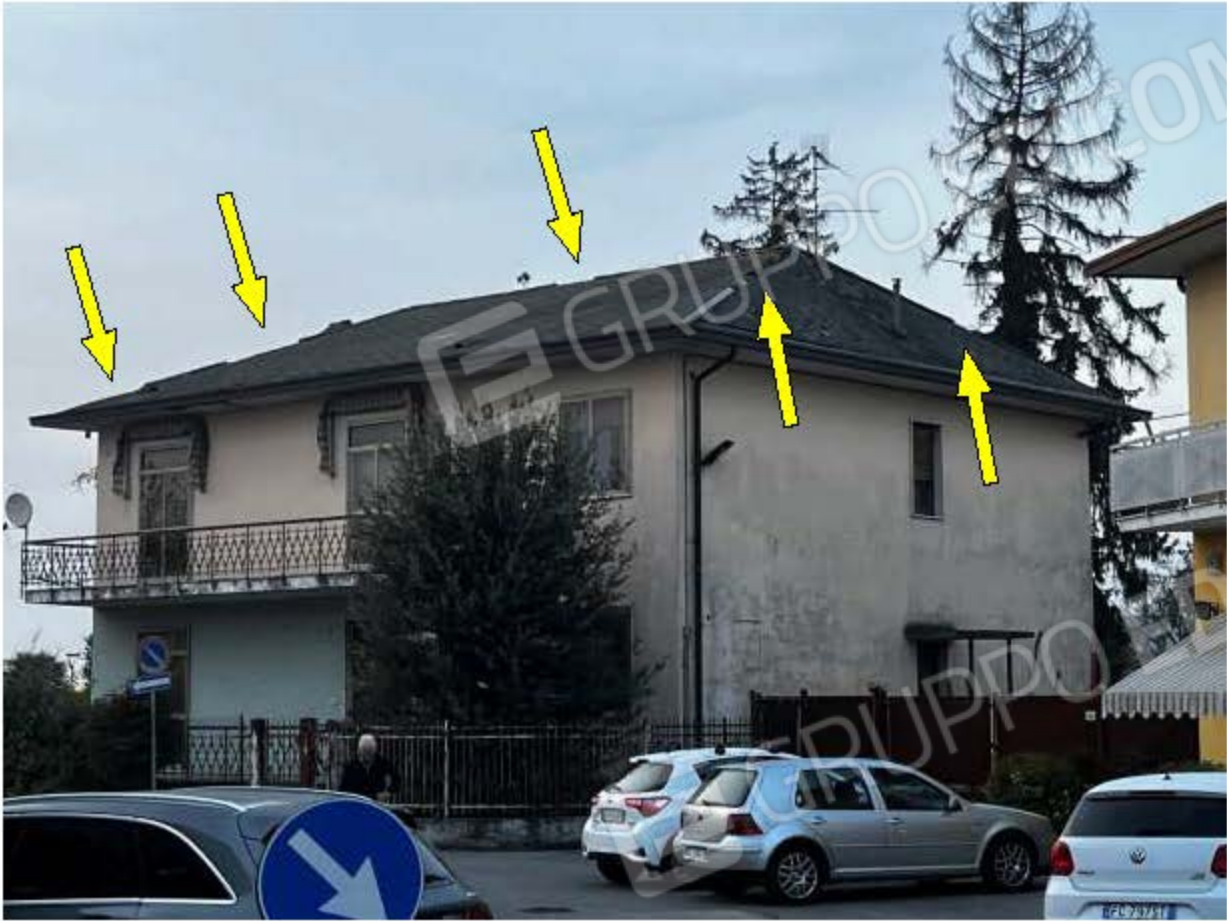
DANNI ALLA COPERTURA
