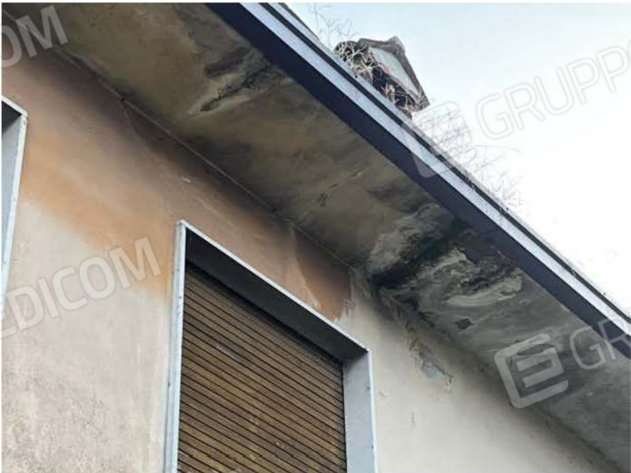
DANNI PER INFILTRAZIONE ALLA GRONDA
