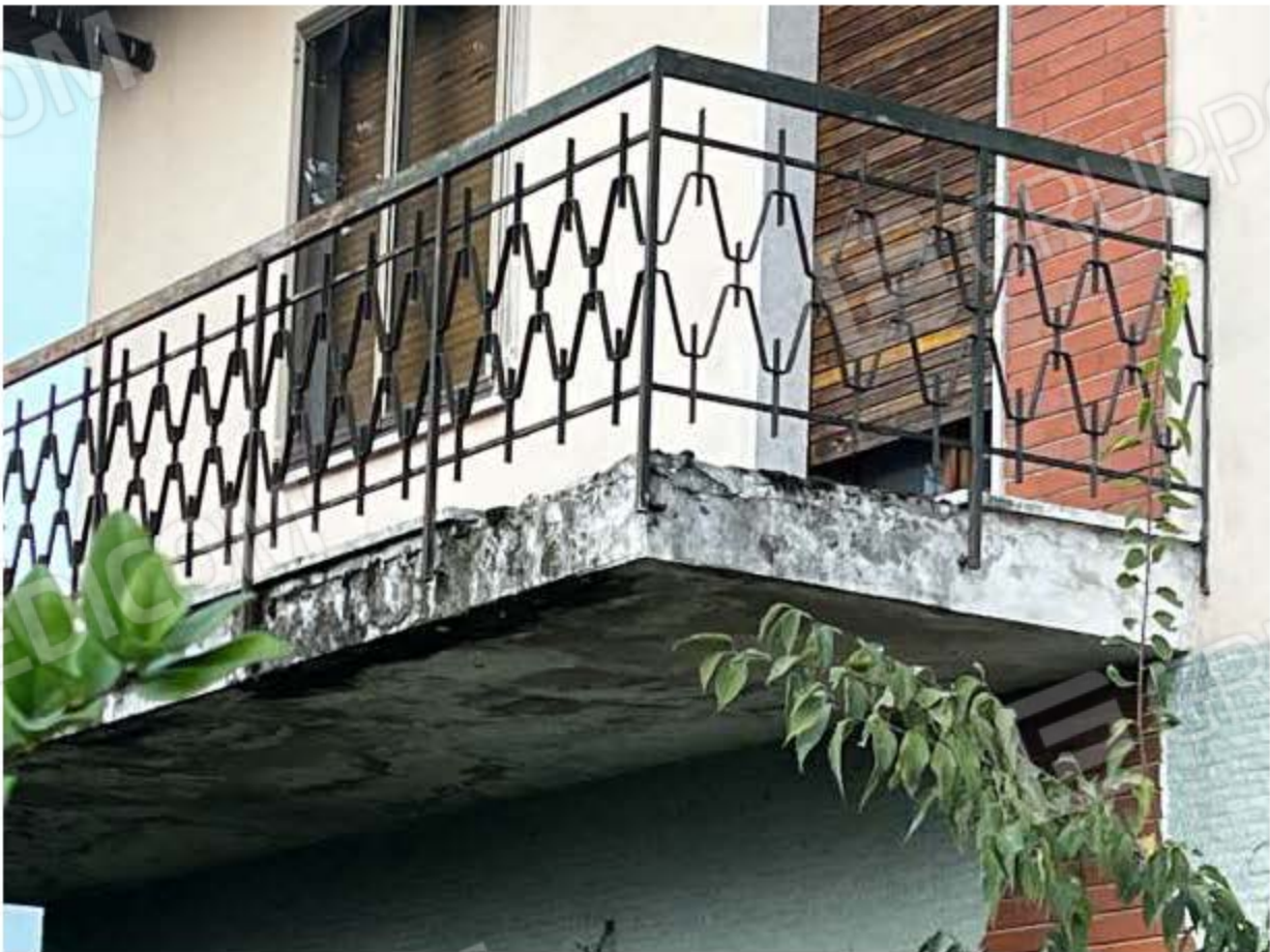
DISTACCO DELLA PAVIMENTAZIONE DEL BALCONE
