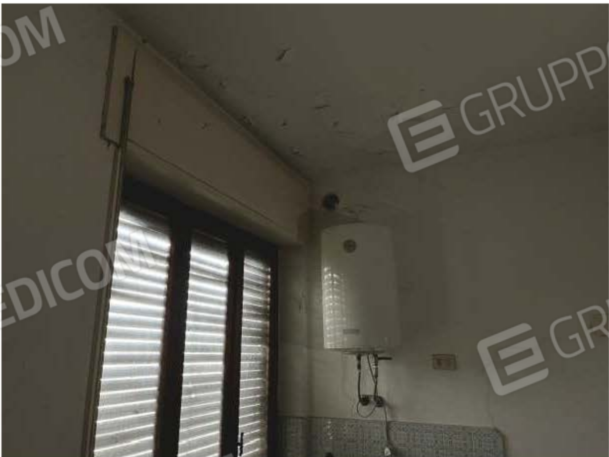
DISTACCO DELLA TINTEGGIATURA DAL SOFFITTO
