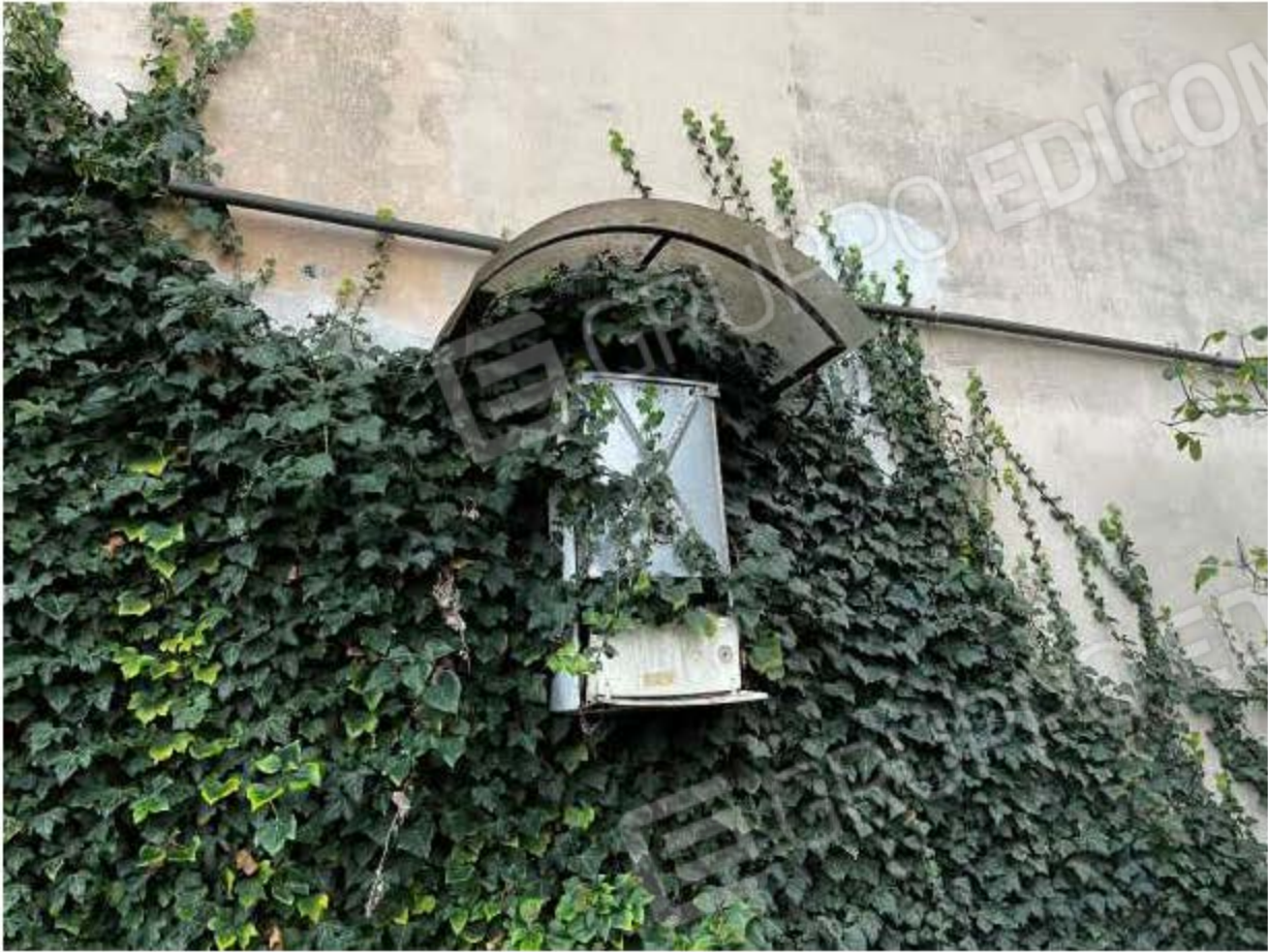
CALDAIA ESTERNA COPERTA DAL VERDE
