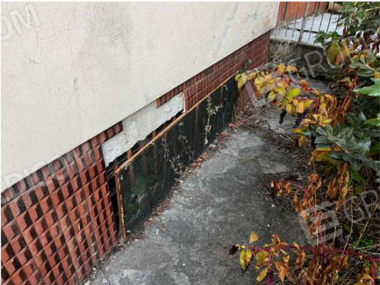
DISTACCO DEL RIVESTIMENTO ESTERNO
