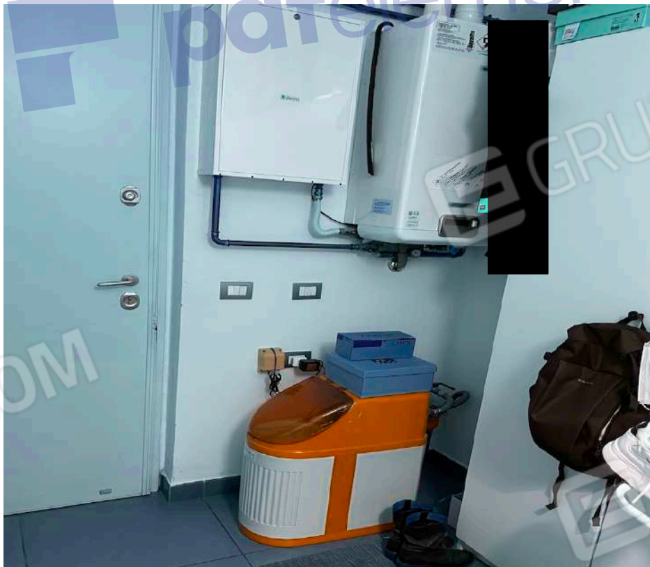
caldaia a condensazione e decalcificatore
