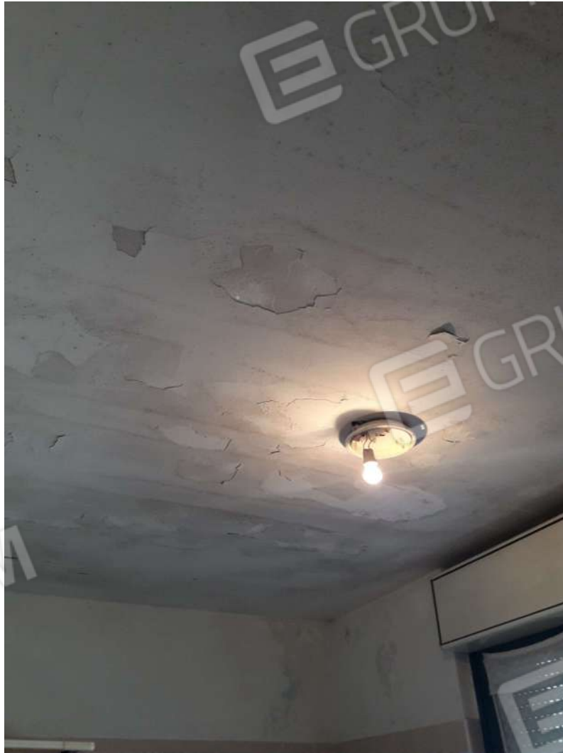
Immagine 10- Part. 305 Sub. 8. Dettaglio dei problemi a pareti e soffitto del bagno.
