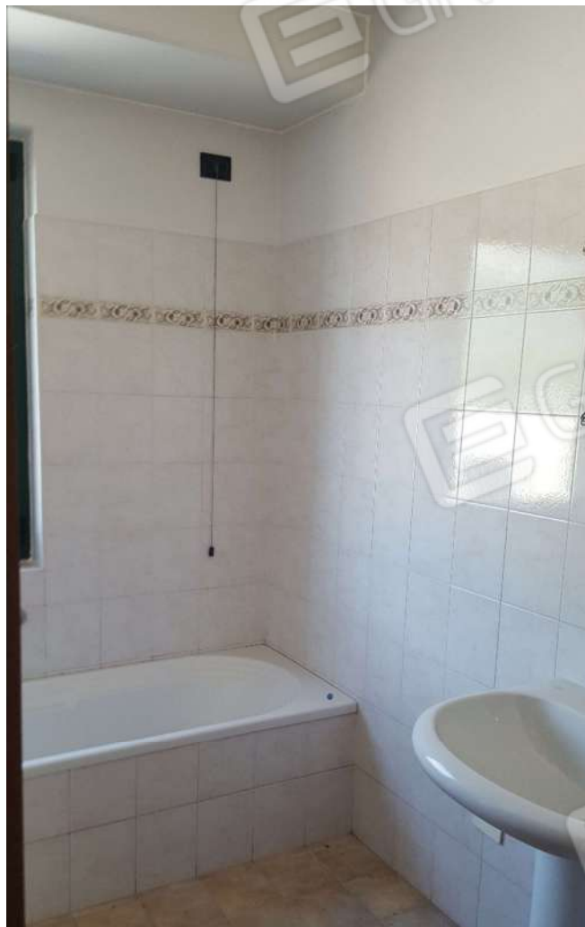
Immagine 28 - Part. 113 Sub. 26. Bagno.
