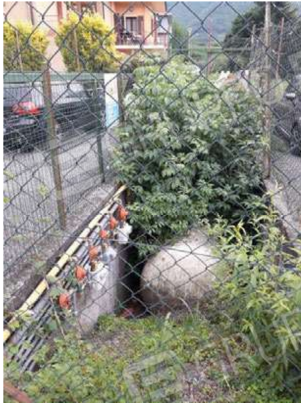
Immagine 38 - Part. 4063 Sub. 15. Area urbana con impianto GPL.
