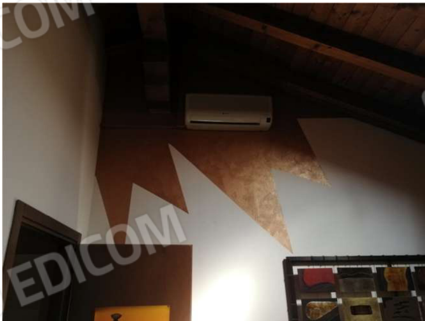
CONDIZIONATORE CAMERA MATRIMONIALE
